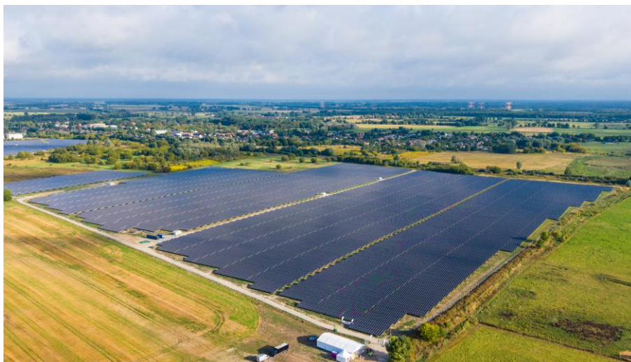
Vattenfall Solarpark in Nauen
