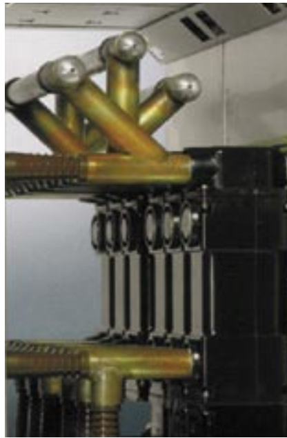
Kupferrohre in Mittelspannungsverteilern
